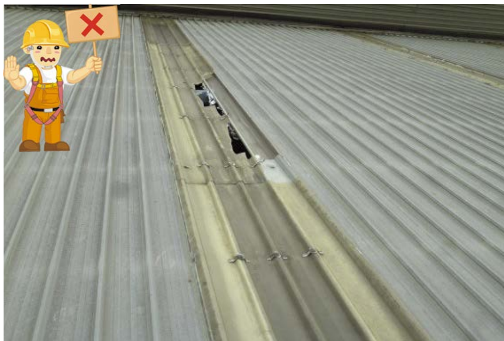
圖 47 於易踏穿材料構築之屋頂作業時，事先未規劃安全通道
