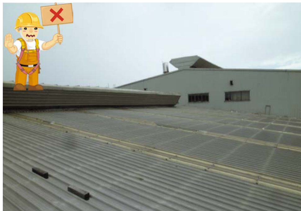
圖 43 塑膠採光罩經日曬雨淋及積塵已不易辨識位置，人員於屋頂作業時容易誤踩踏穿，致由該處墜落
