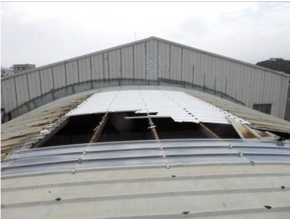
圖 9 易踏穿材質屋頂破裂情形
