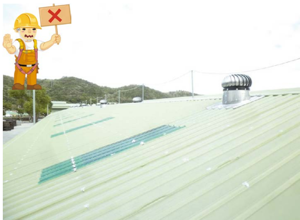
圖 51 人員欲進行易踏穿材質 (塑膠) 屋頂板作業時，未設置防止人員踏穿墜落之安全防護措施
