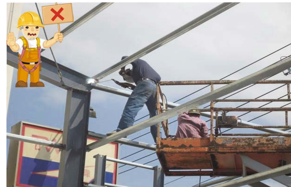
圖 45 勞工未於高空工作車之工作臺內實施作業，且未佩戴安全帶
