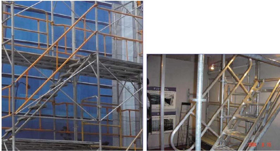
圖 33 上下設備樓梯應有適當護欄
