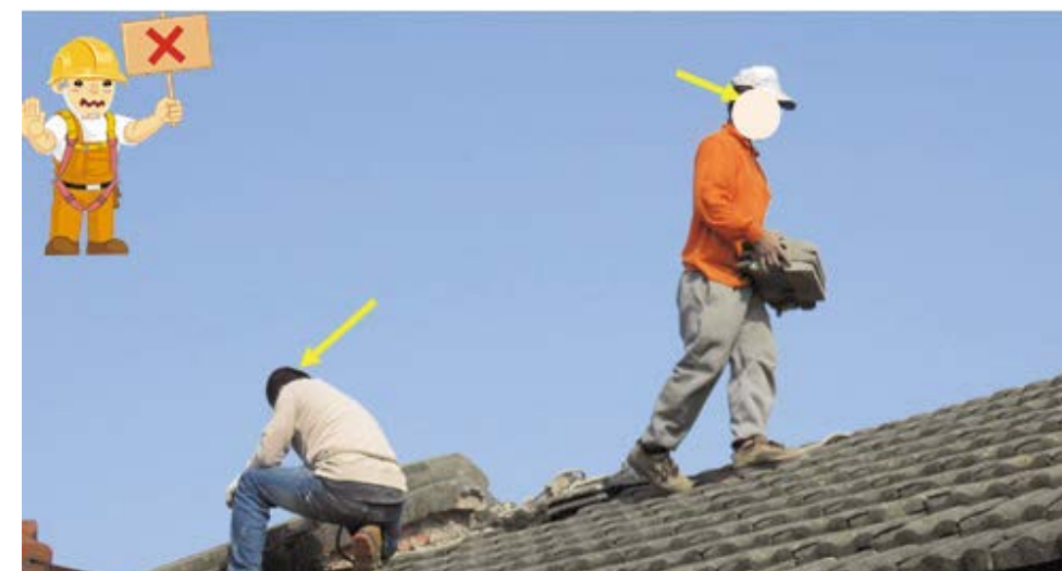
圖 37 從事屋頂作業，未提供勞工安全帽
