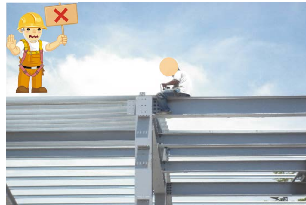
圖 41 跨坐鋼構上作業，未提供或使勞工確實繫掛安全帶
